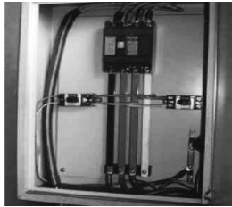
분전반 덮개 탈락
