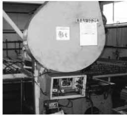
제어반 덮개 탈락
